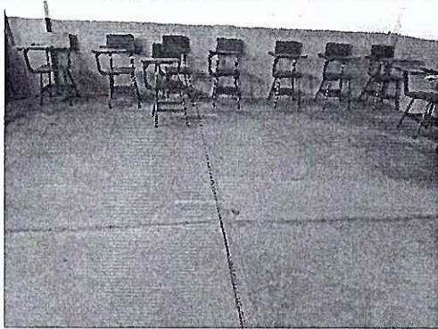
Foto 3: Se observa que el piso de cemento líquido debe mejorarse con piso cerámico
