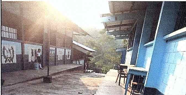
FOTO 3: Se observa el mal estado y oxido de los balcones.
