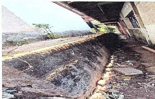
FOTO 2: Se observa el mal estado del canal.
