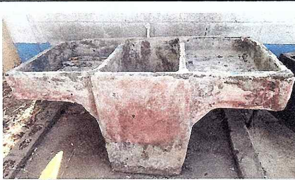
FOTO 7: Se observa el deterioro de la pila. Urge sustitución.
