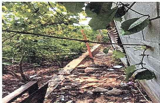
FOTO 1: Se observa la falta de muro perimetral en el centro educativo.
