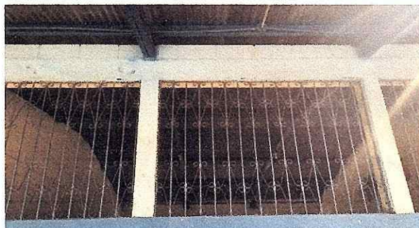
FOTO 4: Se observa el mal estado de la ventana, urge sustitucion por ventana de metal mas vidrio.
