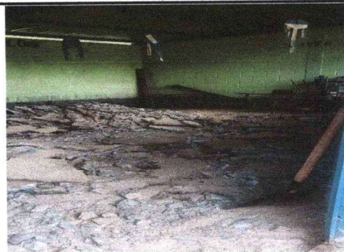
Foto 2: Se observa el levantamiento del concreto en mal estado.
