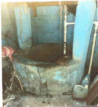
Foto 9: Se observa el mal estado del pozo
