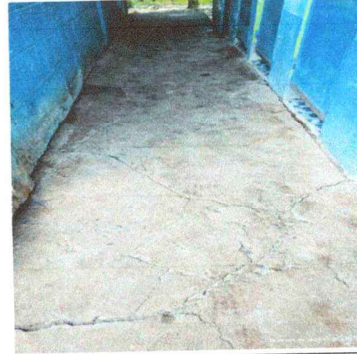
Foto 8: Se observa el mal estado de la banqueta
