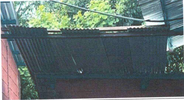
Foto 7: Se observa el mal estado de la lámina
