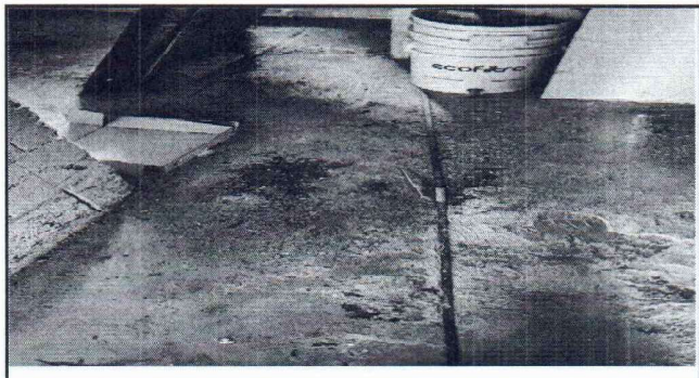
Foto 10: Se observa que es necesario proteger los muros interiores con azulejo . De igual manera mejorar el piso existente.
