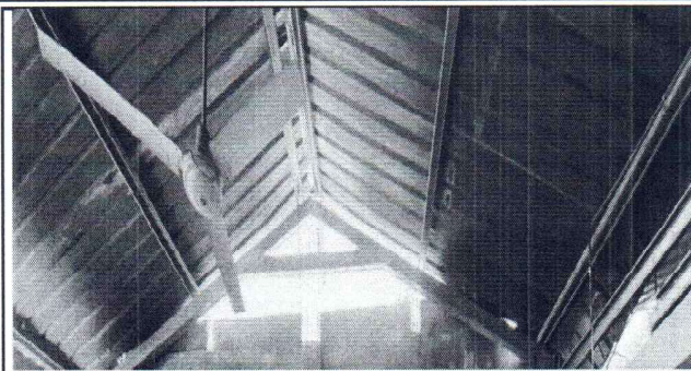
Foto 2: Se observa que es necesario cambiar el techado y darle mantenimiento a la estructura metálica.
