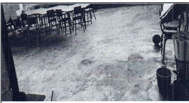
Foto 6: Se observa el mal estado del piso.
