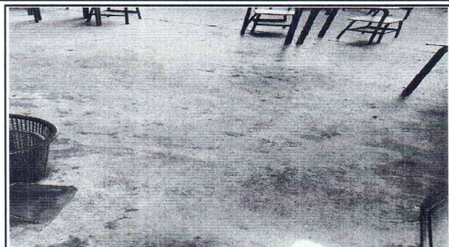
Foto 1: Se observa en mal estado del piso.
