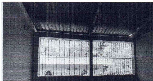
Foto 3: Se observa las ventanas de hierro que necesitan que se les coloque vidrio.
