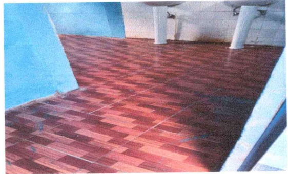
Foto 2: El piso cerámico de los sanitarios quedó bien.
