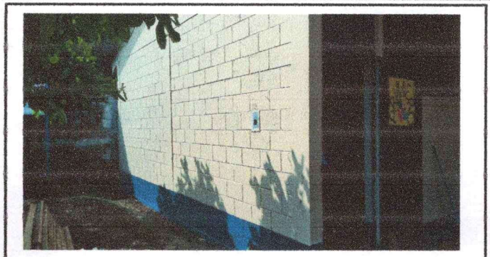
Foto 2: Se observan los muros exteriores de módulo de aulas completamente resanados y pintados
