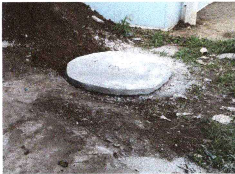
Foto 9: Se observa de tuberías de aguas negras.
