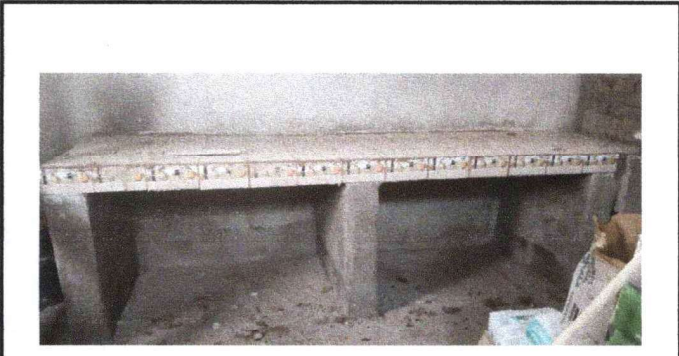
Foto 14: Se observa el banco de trabajo instalado.
