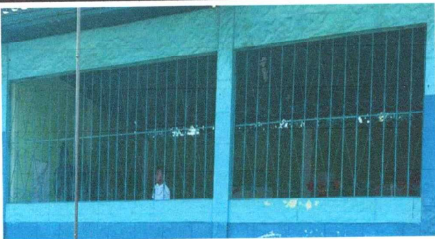
Foto 3: Se observa que los balcones necesitan mantenimiento
