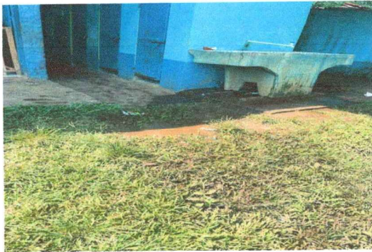
Foto 9: Se observa el mal estado de la tubería de aguas negras
