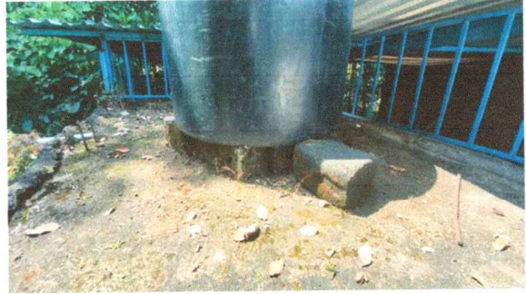
Foto 8: Se observa el mal estado de la terraza del pozo + paneles.
