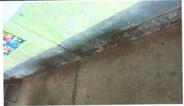
Foto 2: Se observa que es necesario repellar y sellar grietas
