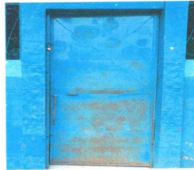
Foto 4: Se observa que las puertas necesitan mantenimiento
