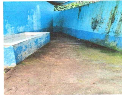
Foto 10: Se observa la necesidad de colocar piso antideslizante
