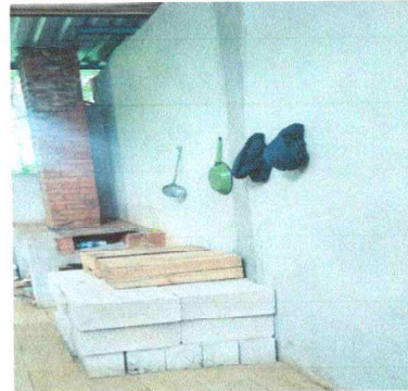
Foto 14: Se observa la necesidad de colocar banco de concreto
