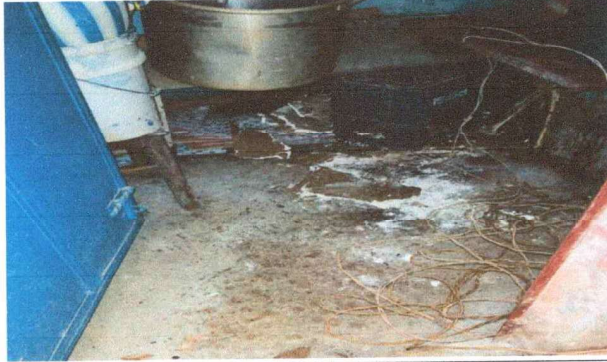
Foto 7: Se observa el mal estado de la torta de concreto
