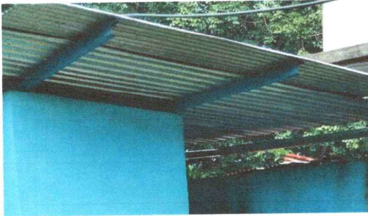
Foto 11: Se observa la necesidad de mejorar el canal de metal
