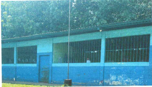
Foto 13: Se observa la necesidad de aplicar pintura
