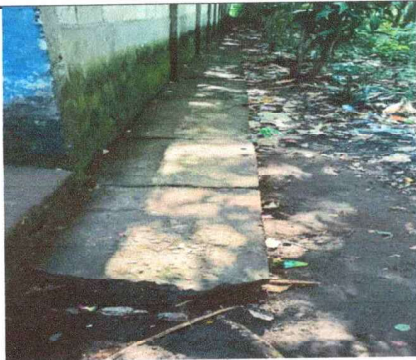
Foto 5: Se observa que es necesario reparar la banqueta
