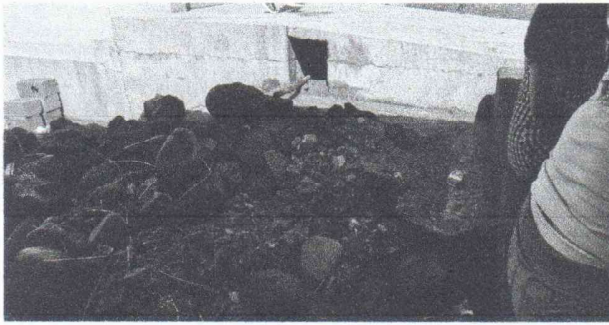
Foto 9: Se observa la necesidad de una caja de registro y la sustitución de tubería.
