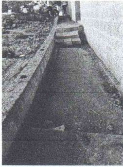
Foto 7: Es necesaria la reparación de la banqueta y la conformación de muro.
