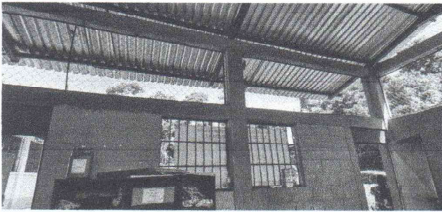
Foto 3: Se observa la necesidad de la sustitución de malla por balcones de metal.
