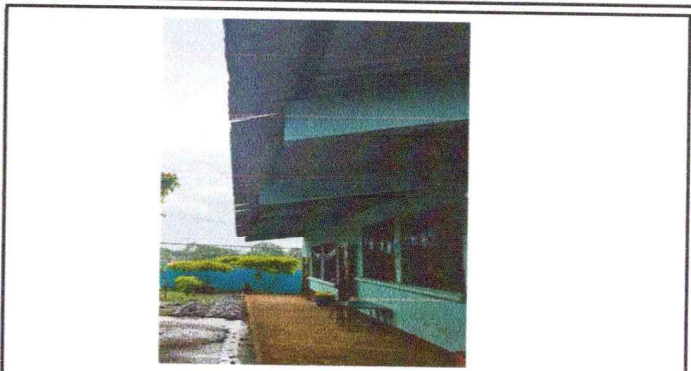
Foto 2: Se observa que las láminas se encuentran deterioradas.
