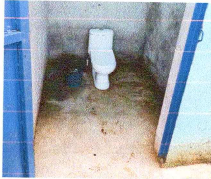
Foto 7: Se observa que no cuentan con piso cerámico los baños.
