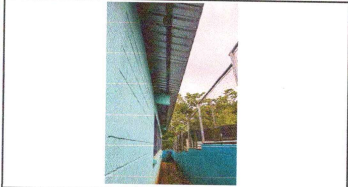
Foto 1: Se observa que no cuenta con canal para el desfogue de agua pluvial.
