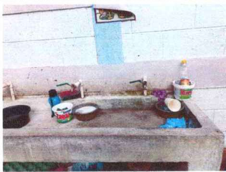
Foto 15: Se observa la necesidad de cambiar los chorros
