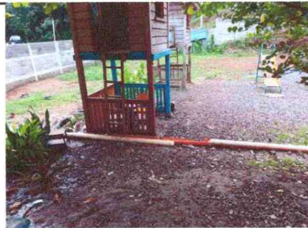
Foto 16: Se observa la sustitución de tubería de pvc de línea principal de aguas pluviales que se conectará a la tubería de la caja para que no quede sobre la tierra.
