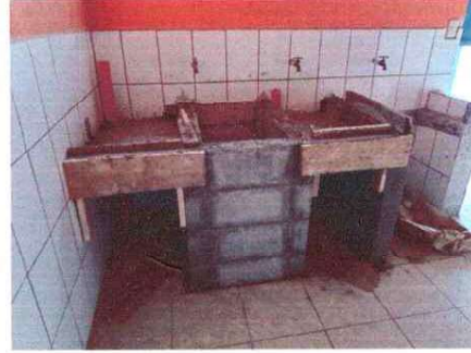
Foto 2: Se observa la de realización de una pila de concreto, la cual se colocó en este sitio
