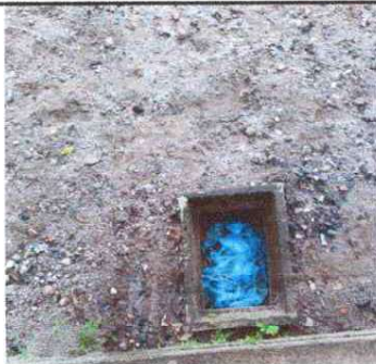
Foto 17: Se observa la necesidad de colocar la tapadera de caja.
