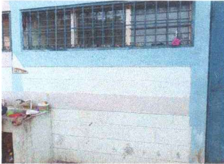
Foto 7: Se observa la necesidad de pintar los muros
