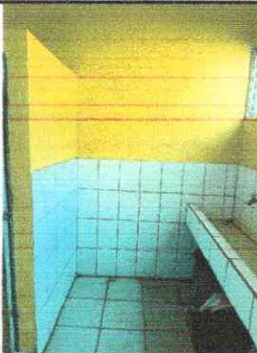
Foto 5: Se observa la necesidad de conformar una puerta
