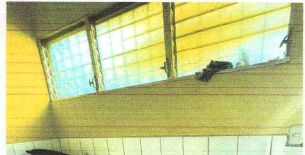
Foto 4: Se observa la necesidad del sistema eléctrico
