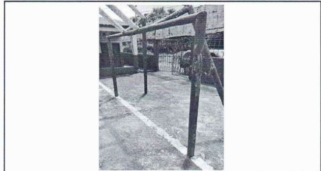
Foto 8: Se observa la estructura de metal de la portería y canasta que se encuentra en el patio, la cual esta deteriorándose y necesita mantenimiento.
