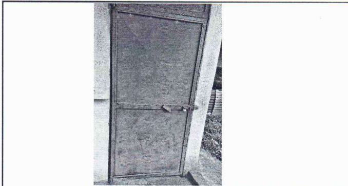
Foto 3: Se observan las puertas en mal estado, por tal motivo necesitan sustitución.
