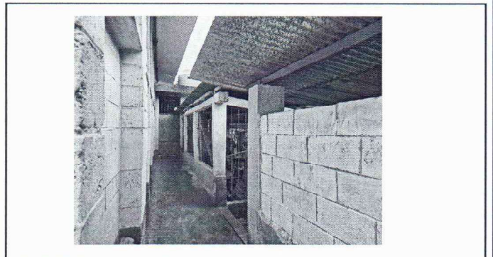
Foto 4: Las paredes de cocina, servicio sanitario y salón de clase, se encuentran en deterioro.
