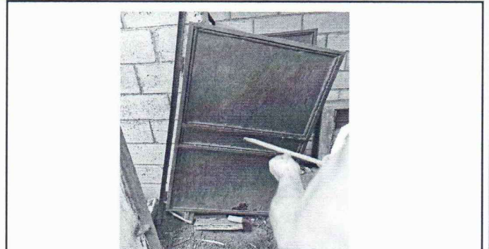
Foto 2: Se observan las puertas de servicio sanitario en mal estado, por lo tanto necesitan mantenimiento.
