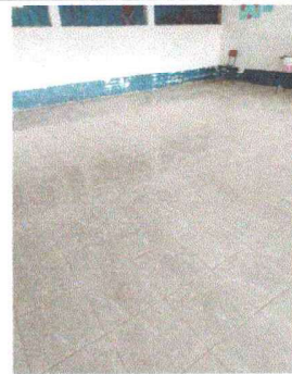
Foto 10: Se observa como quedo el piso en las aulas
