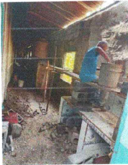
Foto 3: Se observa el repello en los muros en mal estado
