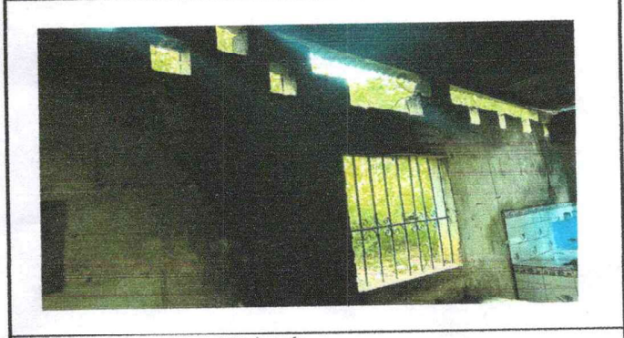
Foto 2: Se observa muro deteriorado.
