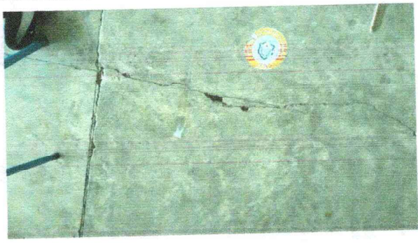
Foto 10: Se observa el piso en mal estado
