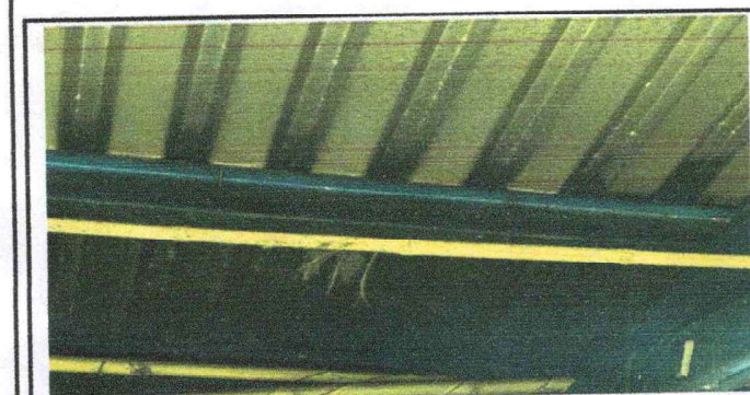
Foto 5: Se observa lámina deteriorada.
