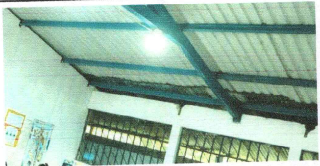
Foto 11: Se observan láminas en mal estado.
