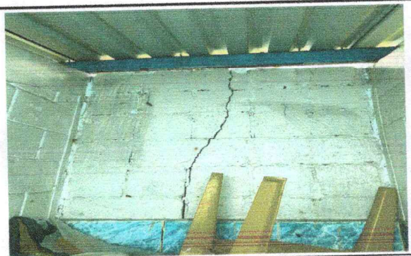
Foto 9: Se observa muro actualmente en mal estado.
