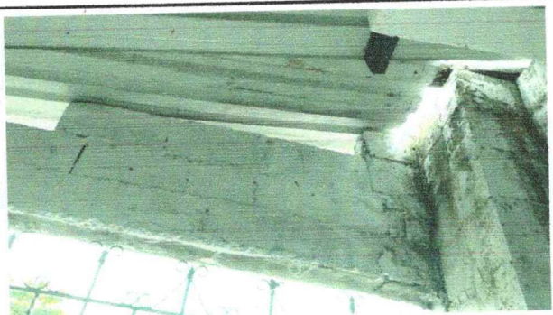
Foto 12: Se observa estructura de madera en mal estado.
