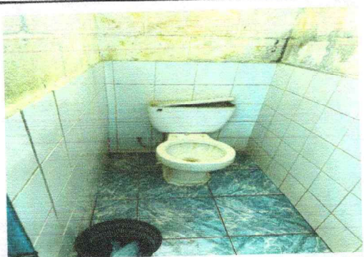
Foto 7: Se observa el mal estado de los sanitarios
