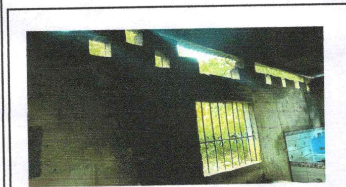
Foto 3: Se observa el muro sin repello
