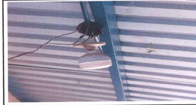
Foto 4: Se observa que el sistema eléctrico está en mal estado.
