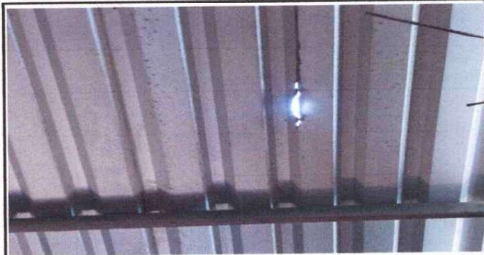
Foto 1: Se observa que las láminas de la cocina están en mal estado.
