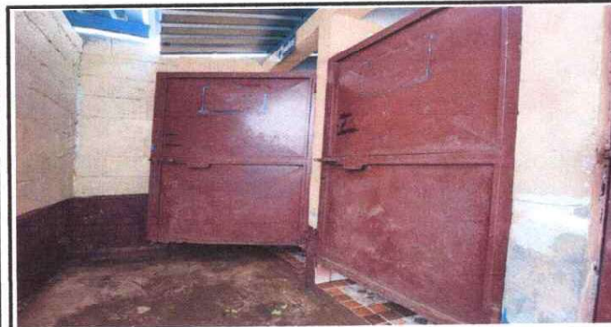
Foto 3: Se observa que las puertas del baño están en mal estado.
