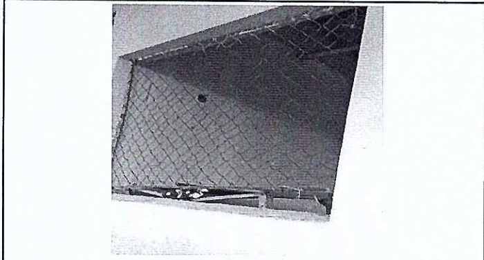
Foto 1: Se observa el mal estado de la ventana de madera y malla en el módulo de aulas
