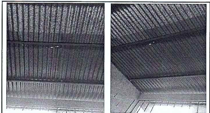
Foto 2: Se observa las lámina de zinc con agujeros, urge su sustitución. Asimismo, es necesario dar mantenimiento a la estructura de soporte de metal.
