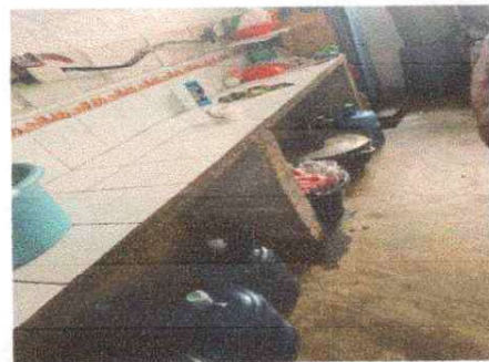
Foto 6: No se cuenta con azulejo.
