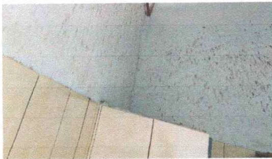
Foto 17: SE observa que no cuenta con pintura.
