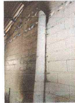
Foto 4: Chimenea en mal estado.
