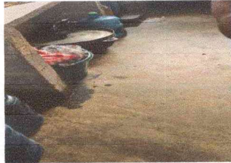
Foto 8: No cuenta con piso cerámico.
