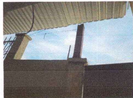
Foto 18: Se observa que no hay balcón en esa área.
