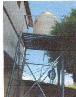
Foto 22: Se observa la necesidad de cambio de accesorios debido que tiene mucha fuga
