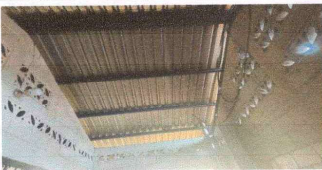
Foto 11: No cuentan con pintura las paredes.
