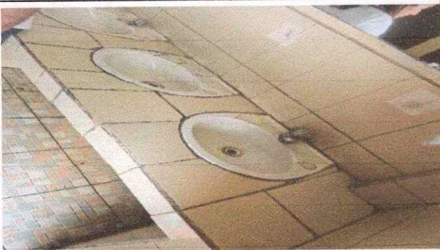
Foto 13: Se observa los lavamanos incompletos.
