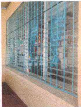
Foto 21: Se observa que los balcones necesitan mantenimiento
