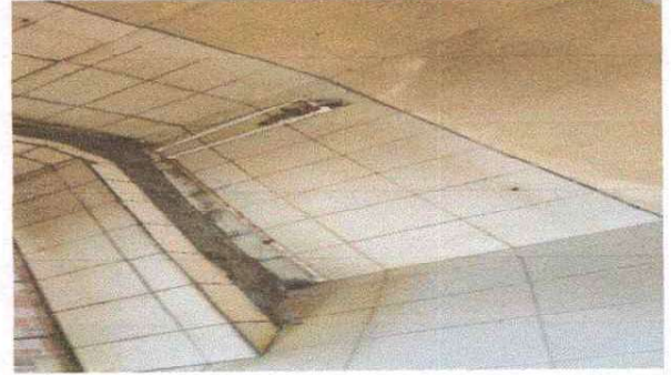
Foto 14: Se observa en mal estado el mingitorio
