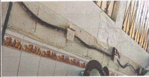
Foto 7: Sistema eléctrico en mal estado.
