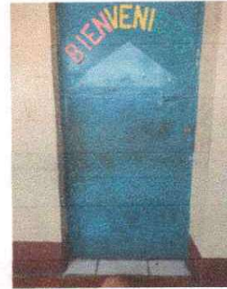
Foto 20: Se observa que las puertas necesitan mantenimiento
