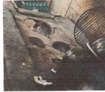
Foto 2: Se observa el mal estado de la plancha de metal de las estufas.
