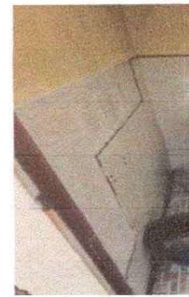
Foto 16: Se observa que falta cerámico en los baños
