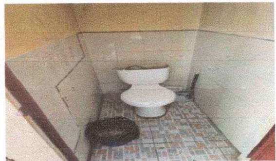
Foto 12: Se observan los sanitarios en mal estado.
