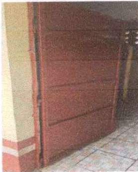
Foto 15: Se observa un mal estado de puertas
