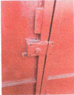
Foto 19: Se determinó que las chapas están en mal estado.
