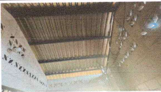
Foto 5: No están repelladas las paredes.
