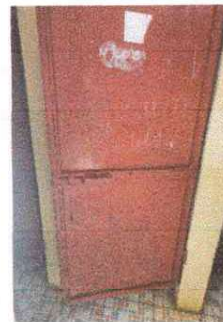
Foto 10: Se observa puerta en mal estado.
