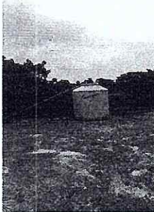
Foto 9: Se observan sin funcionamiento y en mal estado el deposito de agua
