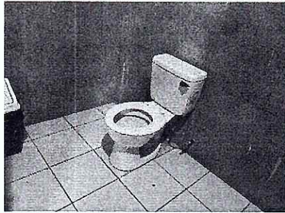
Foto 1: Se observa el mal estado y sin funcionamiento los servicios sanitarios
