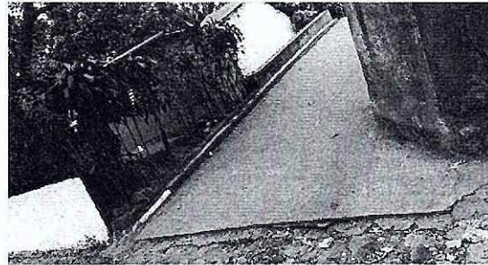
Foto 10: Se observa que no cuentan con un porton para cerrar el establecimiento
