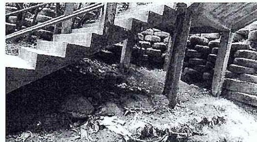
Foto 6: Se observa que es necesario realizar mantenimiento de los muros de block
