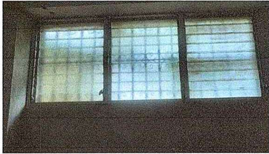
Foto 1: Se observan las paletas de vidrio completas
