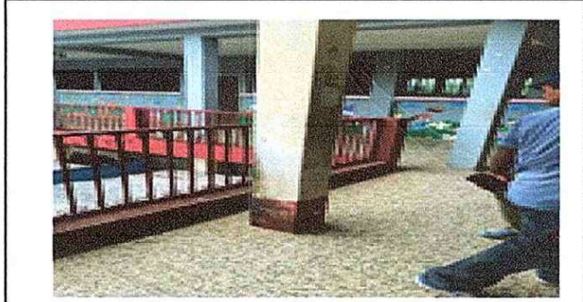
Foto 4: Se observa la columna necesita limpieza y tallado
