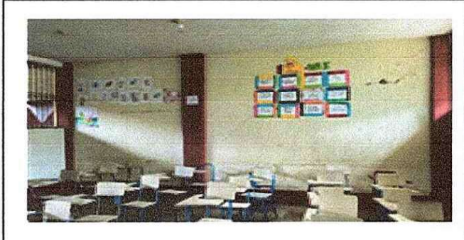
Foto 3: Se observa la estructura del aula con grietas
