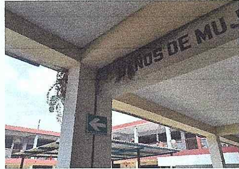
foto 2 los muros exteriores se ven deteriorados por lo cual necesita reparación
