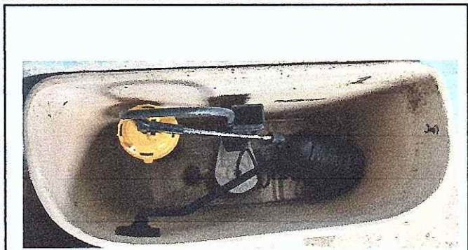
Foto 1 Se puede observar que los accesorios de los servicios sanitarios se encuentran deteriorados y sin funcionamiento
