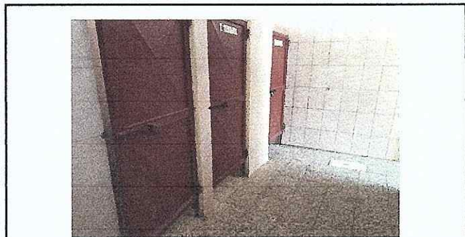
Foto 3 se realizara sustitucion de puertas que se encuentran deterioradas
