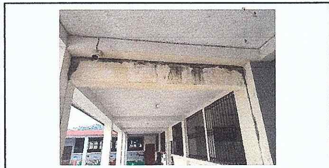
Foto 5 se puede observar que las juntas sismicas de losa se encuentra deteriorada
