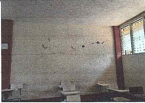
Foto 1 se puede observar que la pared de las aulas se encuentran agrietadas por lo que necesita reparación
