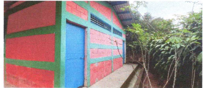
Foto 10: Se observa la necesidad de aplicar pintura en los muros
