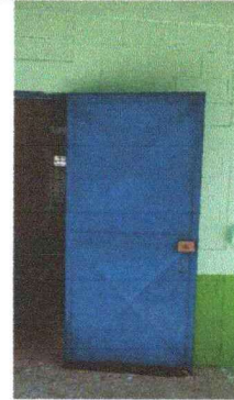
Foto 8: Se obseva la necesidad de sustituir puertas
