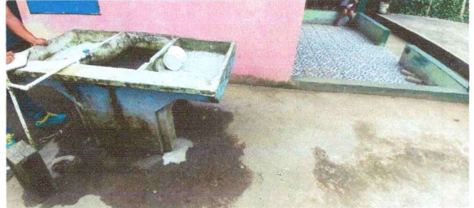
Foto 2: Se observa la necesidad de crear una pila
