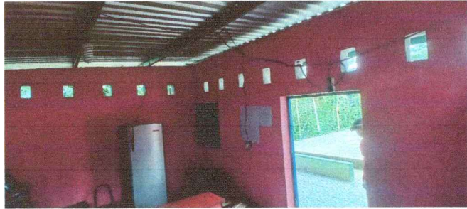
Foto 1: Se observa la necesidad de cambio de sistema electrico
