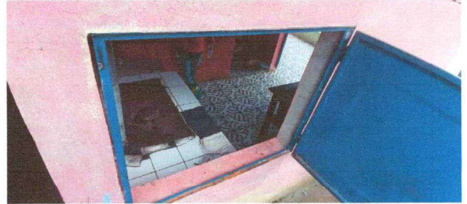
Foto 4: Se observa la necesidad de instalar ventanas
