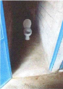
Foto 7: Se observa la necesidad de colocar piso ceramico
