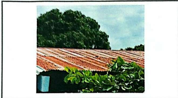
Foto 1: Se observa la lámina deteriorada.
