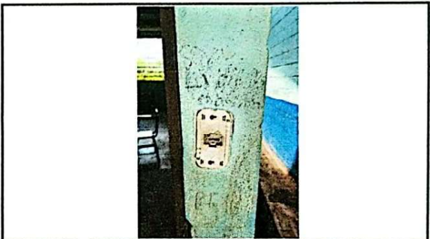
Foto 4: Se observa los accesorios del sistema eléctrico sin funcionamiento.
