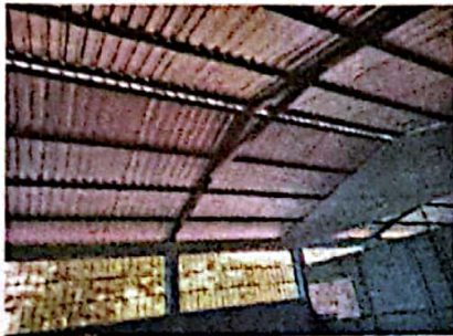
Foto 3: FOTOGRAFIA SUMINISTRO E INSTALACION DE ESTRUCTURA PORTANTE DE METAL, LAMINA TROQUELADA CALIBRE 26
