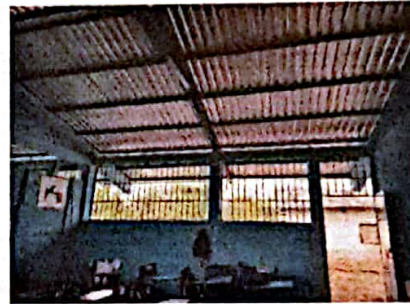
Foto 4: FOTOGRAFIA SUMINISTRO E INSTALACION DE ESTRUCTURA PORTANTE DE METAL, LAMINA TROQUELADA CALIBRE 26
