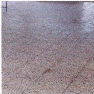
Foto 7: FOTOGRAFIA ESTADO ACTUAL DEL PISO DEL AULA
