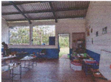
Foto 5: FOTOGRAFIA ESTADO ACTUAL DEL PISO DEL AULA
