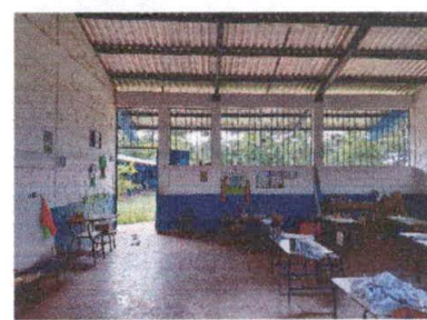
Foto 6: FOTOGRAFIA ESTADO ACTUAL DEL PISO DEL AULA
