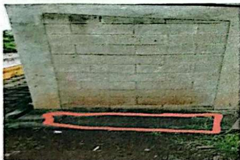
Foto 9: Se observa la necesidad de colocar torta de cemento donde estaran los lavamanos.
