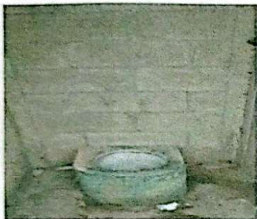
Foto 7: Se observa la necesidad de colocar piso ceramico en el modulo de baños en mal estado
