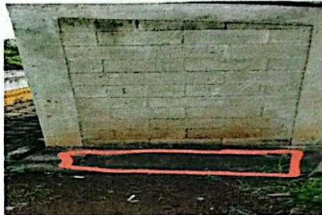
Foto 8: Se observa la necesidad de instalacion de lavamanos.
