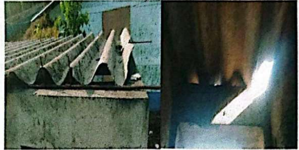
Foto 2. Se observa la necesidad del cambio de estructura ya que esta en mal estado.
