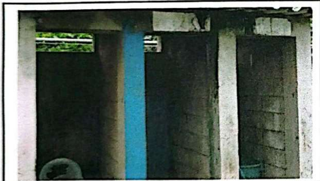
Foto 3: Se observa la necesidad de colocar puertas de metal en los baños.
