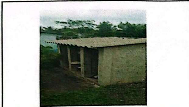
Foto 1. Se observa la necesidad de cambiar las laminas del modulo de baños debido al mal estado que se encuentran.
