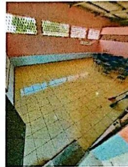
Foto 4: Se observa que el piso de aula se suministró piso cerámico. 29/11/2024
