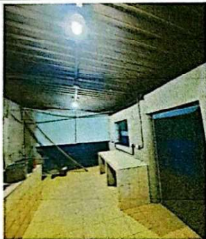
Foto 3: Se observa el sistema eléctrico en óptimas condiciones luego de ser sustituido. 29/11/2024
