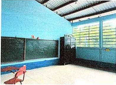
Foto 1: Al módulo 1 y 4 se sustituyo la torta de cemento por piso cerámico.
