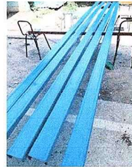
Foto 4: Se procede a cambiar la estructura de metal del techo de la cocina.
