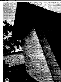
Foto 10: Se observa que la lamina del baño necesita sustitución debido que tiene muchos años.
