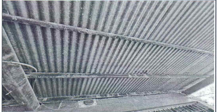
Foto 2: Se observa el mal estado de la costanera.
