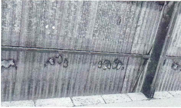
Foto 1: Se observa que la lamina esta picada y en mal estado evidenciando los agujeros que tiene.
