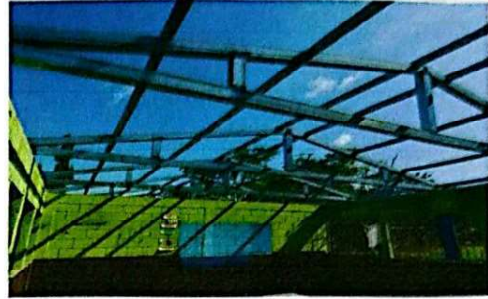
Foto 2: Se observa el cambio de la estructura de madera por la de metal.
