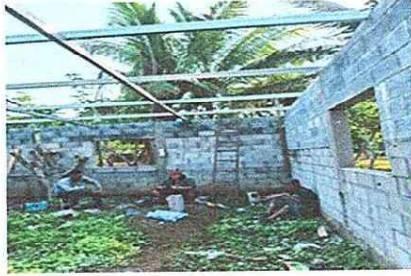
Foto 1: se procede a al levantamiento de techo para la sustitución de estructura
