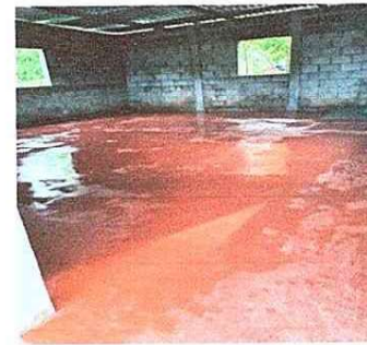
Foto 4: se procede limpiar y arreglar el area donde va quedar la pileta de lavado
