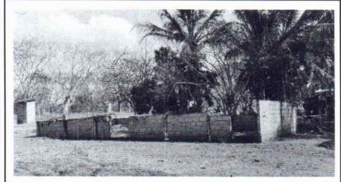
Foto 1: Se observa que el módulo necesita la conformación de estructura portante de metal, la instalación de lámina troquelada y la instalación de puerta.
