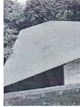
Foto 4: Se observa que la lámina en el modulo 1 ya inicia a oxidarse, por lo que es necesario darle mantenimiento antes de que se deteriore aún más.
