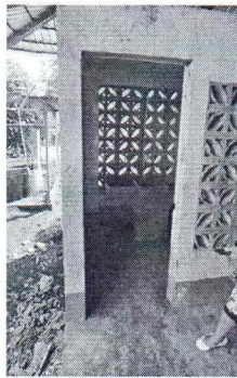
Foto 3: Se observa que hace falta una puerta en el area de lavado de los servicios sanitarios.
