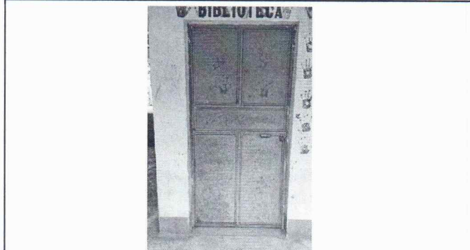
Foto 7: Se observa que las puertas del modulo de aulas 2 del primer y segundo nivel, se encuentran en mal estado y se les debe dar mantenimiento.
