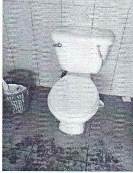
Foto 1: Se observa que los inododos estan rotos y presentan fugas. Deben ser cambiados
