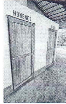
Foto 2: Se observa que las puertas de los baños son de madera, ya no cierran y estan en mal estado, por lo que se busca cambiarlas por unas de metal.
