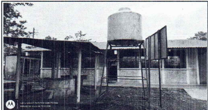
Foto 4: Se observa que las paredes estan muy sucias. Es necesario resane y aplicación pintura latex acrílica en muros exteriores e interiores ( incluye mejora en deformaciones y agujeros. Aula de Parvulos.
