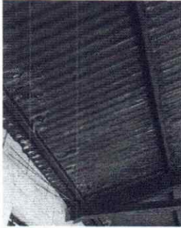
Foto 1: Se observa necesario la sustitución de la lámina por lámina troquelada calibre 26 en el módulo 1.
