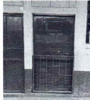
Foto 4: Se observa la necesidad de realizar mantenimiento a las puertas de los módulos 1 y 2.
