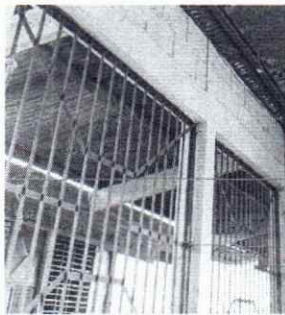
Foto 5: Se observa necesario realizar el mantenimiento a los balcones de los ventanas de los módulos 1 y 2.
