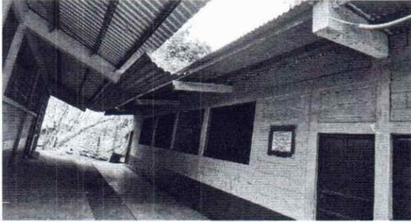
Foto 7: Se observa necesario realizar la instalación de canal de metal incluyendo bajada de agua de los módulos 1 y 2.
