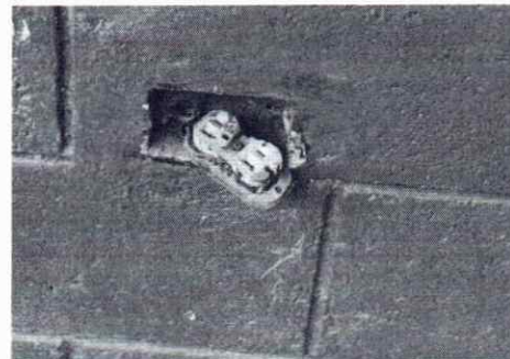
Foto 6: Es necesario realizar la sustitución del Sistema Eléctrico de los módulos 1 y 2.
