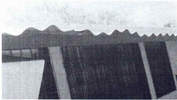
Foto 9: Se observa la necesidad de realizar la sustitución de la lámina existente por lámina troquelada calibre 26.
