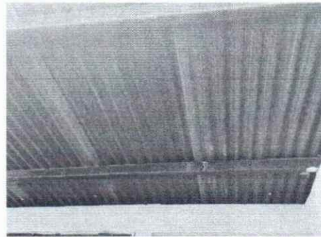
Foto 10: Es necesario que se realice la sustitución de la estructura de metal.
