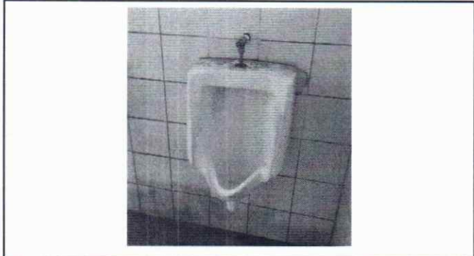
Foto 3: La llave de paso del migitorio, se encuentra en malas condiones, se dee sustituir.
