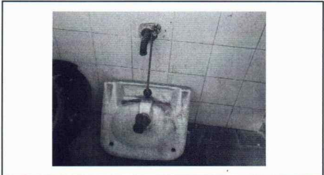
Foto 4: El lavamanos ya no funciona, debe ser sustituido.
