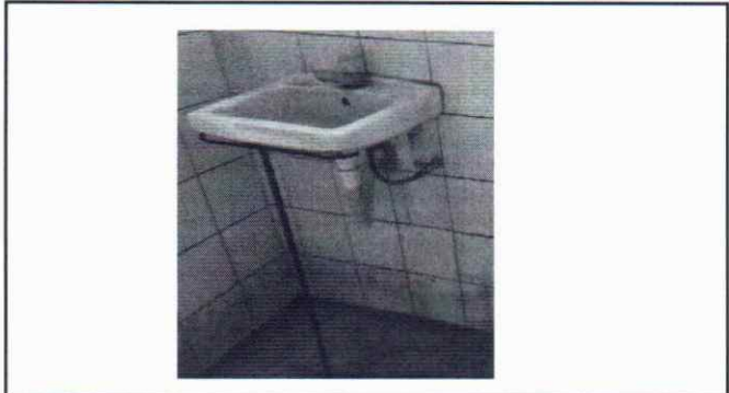
Foto 2: Los accesorios del lavamanos no funcionan, por dicha razón se deben sustituir.
