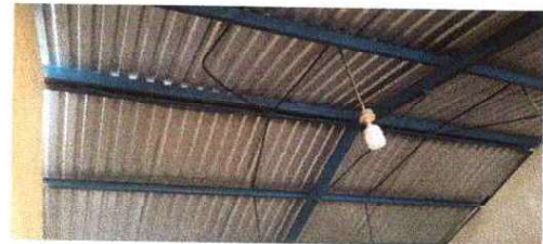
Foto 4: Se Observa: El montaje de la lamina y estructura de metal debidamente terminado.
