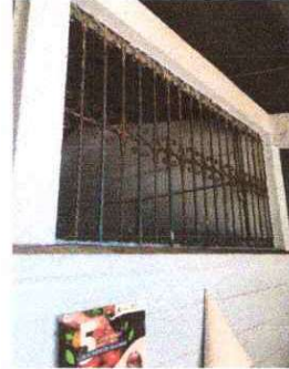
Foto 2: Se observa que los balcones, se encuentra en mal estado
