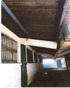
Foto 1: Se observa que la lámina de zinc, se encuentra en mal estado, estructura necesita mantenimiento.
