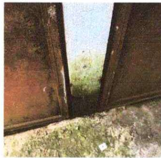
Foto 3: Se observan las puertas que se encuentra en mal estado
