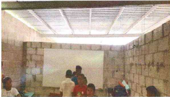
Foto 5: Se observa que aulas puras carecen de energía eléctrica
