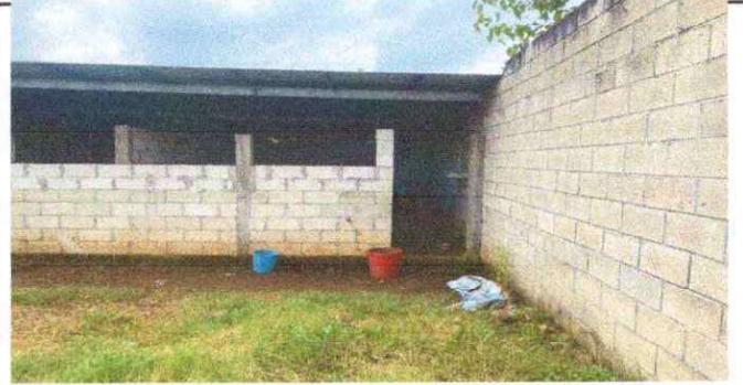
Foto 2: Se observa que los muros exteriores e interiores necesitan mantenimiento (repello)
