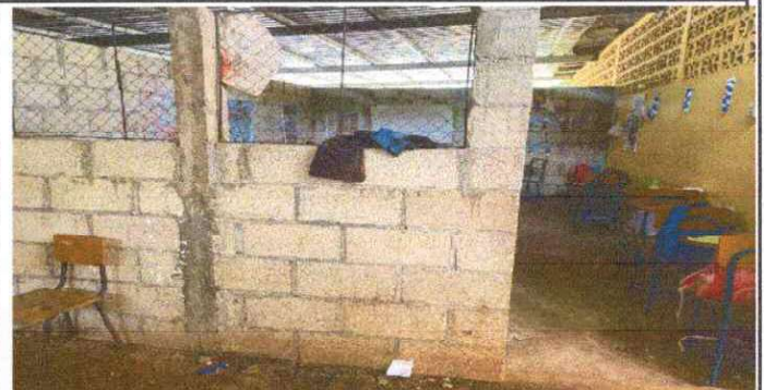
Foto 4: Se observa que aulas puras carecen de balcones
