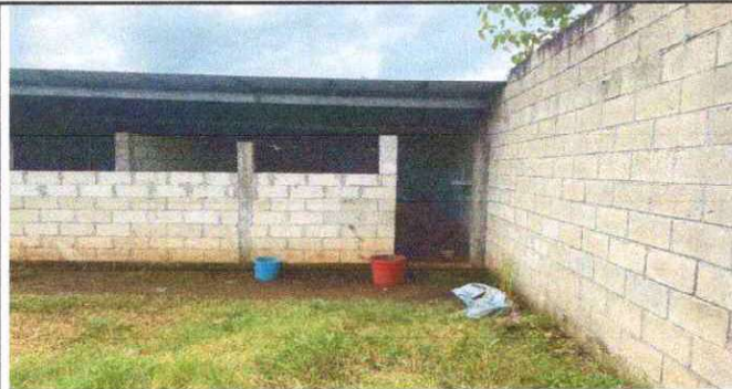
Foto 3: Se observa que en aulas puras carecen de puertas
