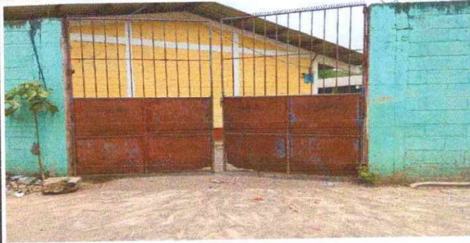
Foto 7: Se observa portón del centro educativo en mal estado
