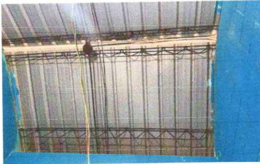
Foto 9: Se observa que el techo de dirección esta en mal estado es necesario sustitución
