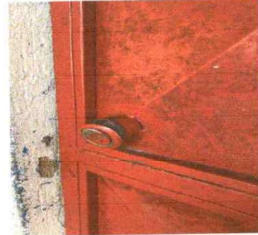
Foto 8: Se observa chapas en puertas que no funcionan correctamente
