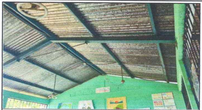
Foto 2: Se observa el deterioro del soporte de metal de las aulas.
