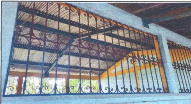
Foto 5: Se observa que los balcones de metal se encuentran en mal estado.
