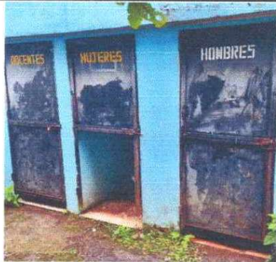
Foto 3: Se observa que las puertas se encuentran en mal estado.
