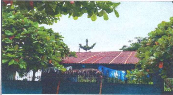
Foto 1: Se observa que la lámina de zinc, se encuentra en mal estado.
