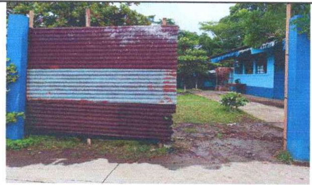
Foto 4: Se observa que el portón se encuentra en mal estado.
