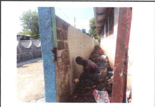
Foto 9: se observa el repello del muro perimetral
