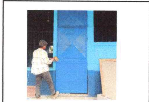
Foto 8: se observacion de cambio de chapa
