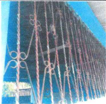
Foto 3: Se ve la necesidad de dar mantenimiento a los balcones en mal estado.
