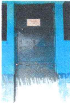
Foto 5: Se observa la necesidad de las puertas que se encuentran en mal estado y la falta de chapas para mayor seguridad.
