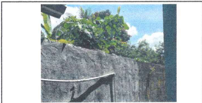
Foto 11: Se observa la necesidad de aplicar sabieta, en el muro perimetral que se ubica en el area de cocina.
