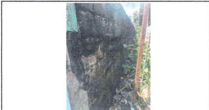
Foto 9: Se observa el muro en la parte frontal de la escuela en mal estado.
