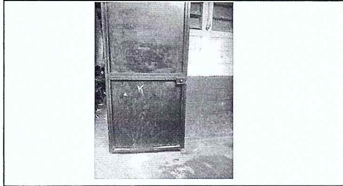
Foto 4: Se observa las puertas del módulo de aulas necesitan mantenimiento preventivo
