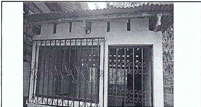
Foto 8: Se observa que la lámina de zinc y estructura portante de madera se encuentra en mal estado, es necesario su sustitución. Asimismo, es necesario la sustitución de ventanas y reparación de balcón de metal.
