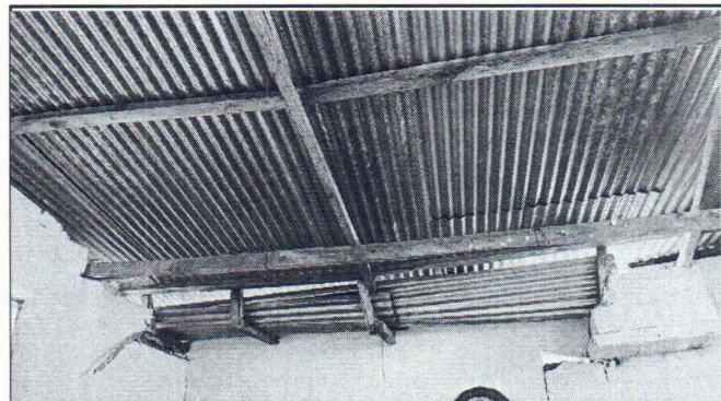
Foto 4: Se observa que la estructura metalica del techo se encuentra en mal estado, y es nesecario cambiarla.
