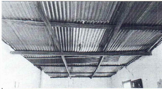
Foto 3: Se observa que la estructura de techo se encuentra en mal estado, por lo que es necesario cambiarla.
