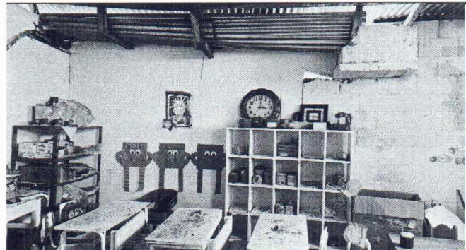
Foto 6: Se observa que la pared se encuentra en malas condiciones, por lo que es necesario reforzarla.
