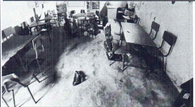
Foto 1: Se observa que el piso se encuentra en mal estado por lo que es necesario cambiarlo.
