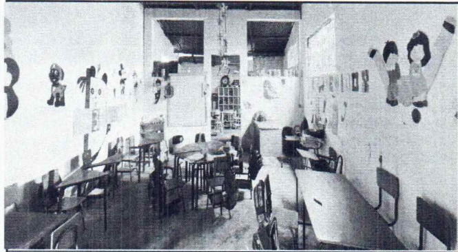
Foto 7: Se observa que las paredes necesitan repello.
